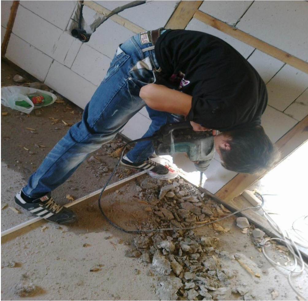
ğekil-25 Teras kat su gideri döÇemesi kırılması
